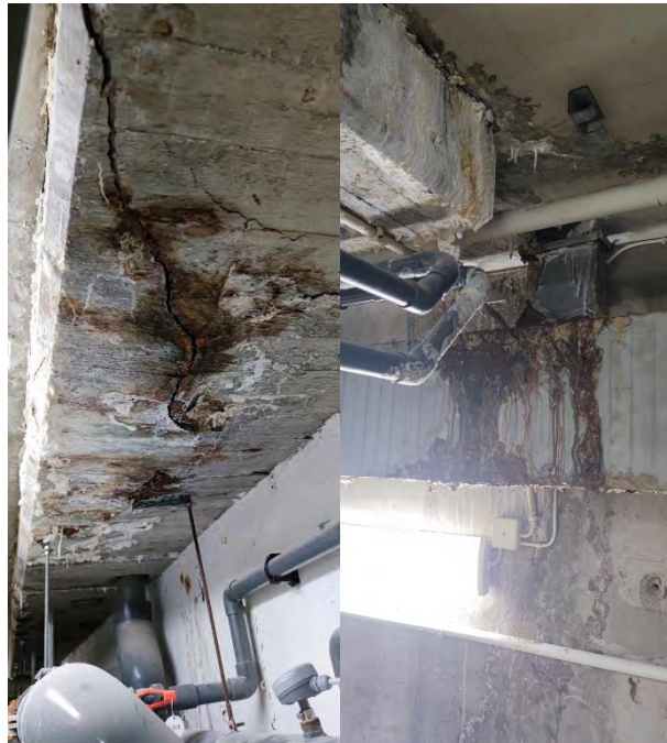
Bilder från källaren under läckande undervisningsbassängen
